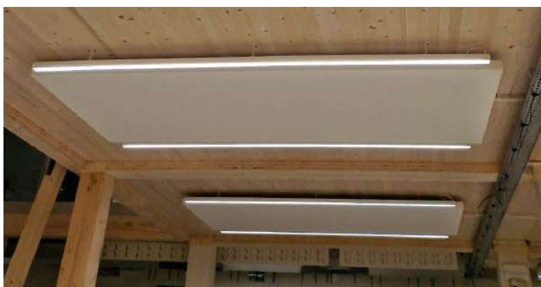
Linéaires ACTiLine4330 en applique, établissements d'enseignements.
